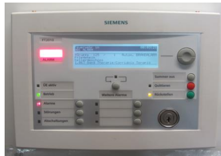
(Unterstation im Alarmfall)
