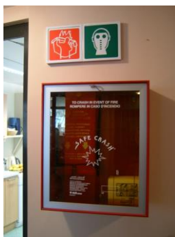
(Wandkasten mit Rauchgasmaske)
